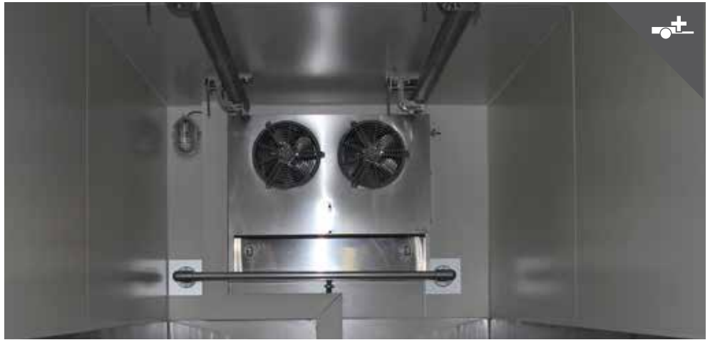
Flachverdampfer und Dachrohrbahn
